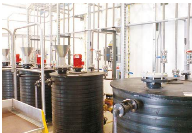
Magazyn chemikaliów Zbiorniki z mieszadłami szybkoobrotowymi TURBO-MIXER
