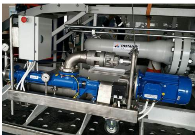
Magazyn paliw Przevoźna pompa monośrubowa ALLWEILER do poboru próbek
